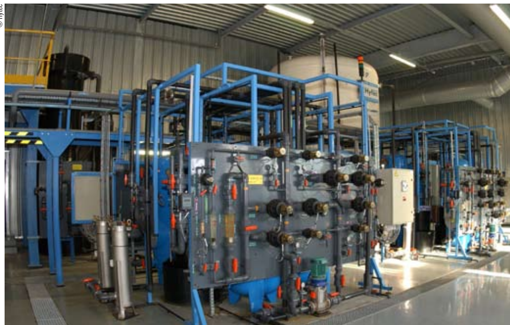
Production d'eau déminéralisée et recyclage de rinçages chez PSA.
