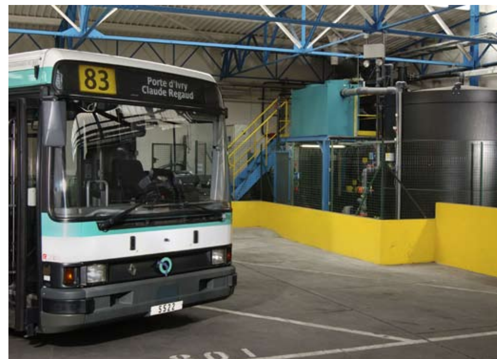
Recyclage d'eau de lavage de bus (déshuileage, épuration biologique, filtration) à la RATP.
